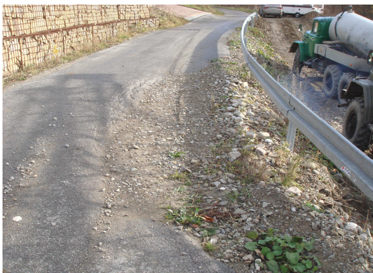
Fot.7 Osuwisko "2" – zniszczenia w obrębie drogi i wykonane zabezpieczenia z gabionów
