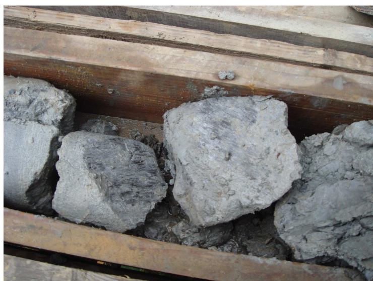
Fot.11 Osuwisko "1" – płaszczyzny poślizgu w otworze Nr O-1 na głębokości 4,7 m ppt
