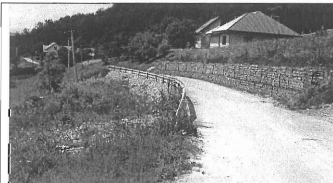
Skarpa główna osuwiska
