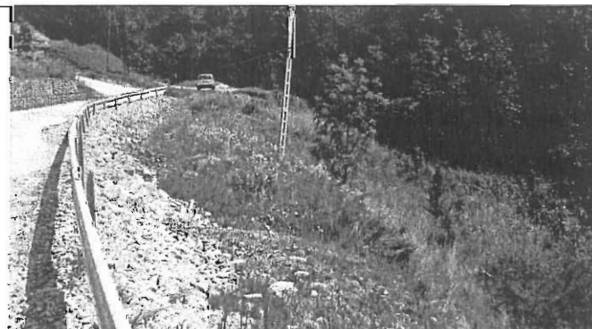
Skarpa główna osuwiska
