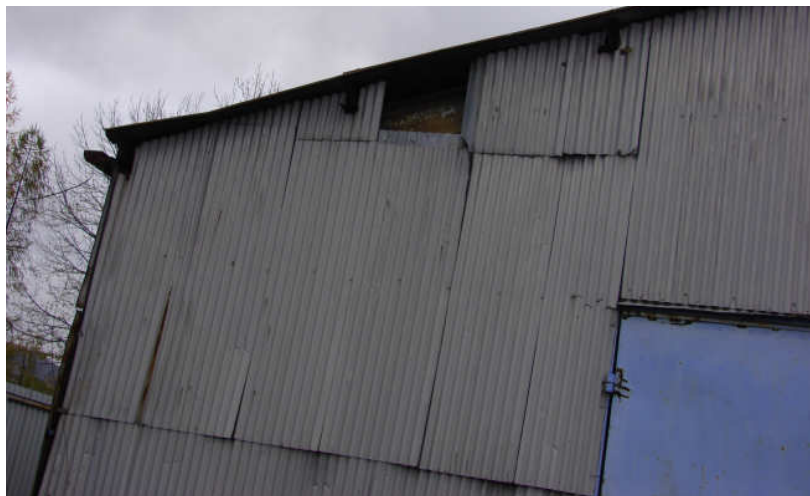
widoczna korozja oraz deformacja i ubytki blachy
