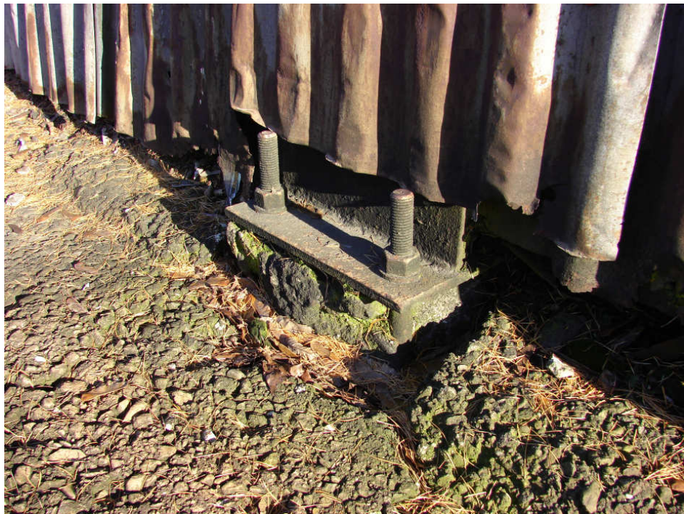
skorodowana i uszkodzona blacha obudowy oraz uszkodzona głowica stopy
