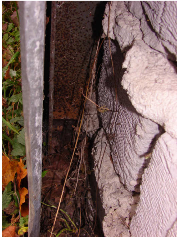
widoczna korozja słupa stalowego
