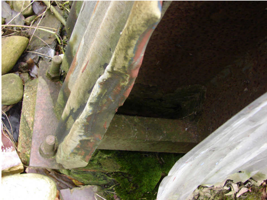
skorodowany środnik słupa stalowego w połączeniu ze stopą fundamentową
