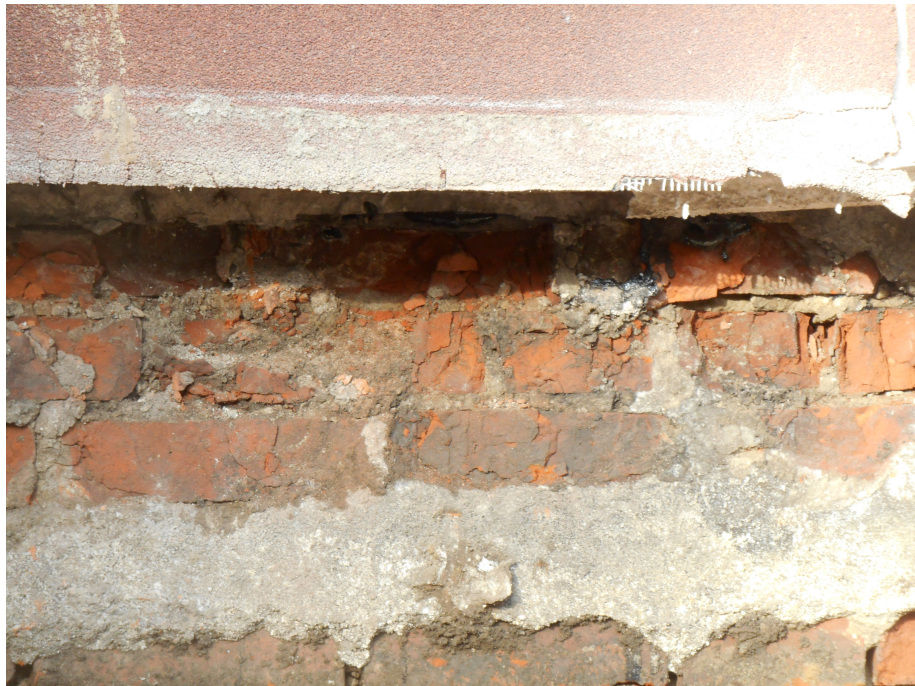
Destrukcja zawilgoconej ściany fundamentowej
