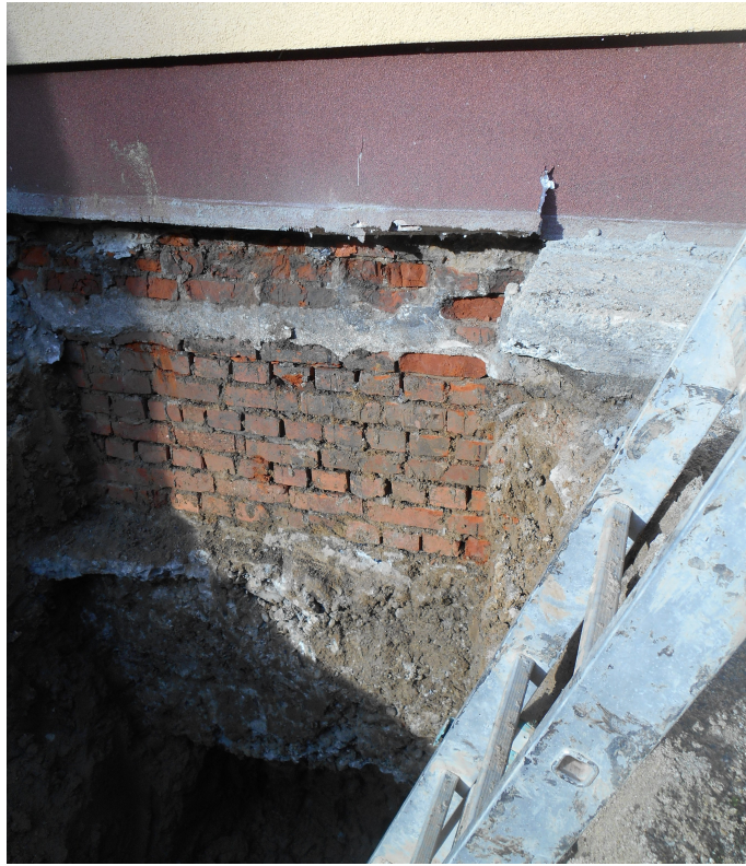
Zawilgocona ściana fundamentowa z cegły pełnej
