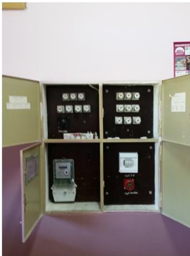
Rys. 4. Rozdzielnia główna w budynku
