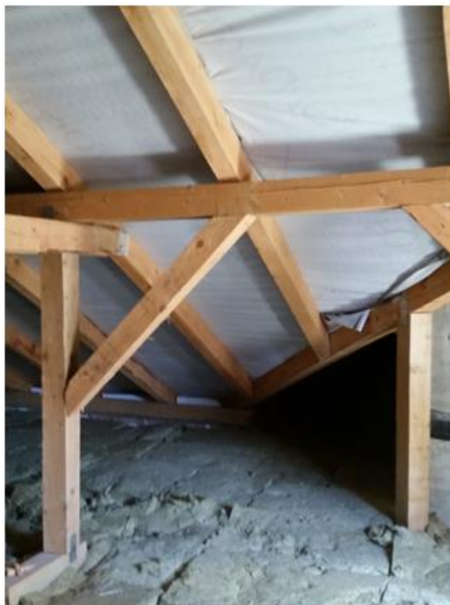
Rys. 2. Stan drewnianej konstrukcji dachowej budynku
