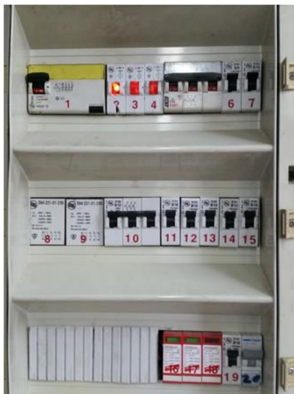
Rys. 5. Rozdzielnia znajdująca się w kotłowni
