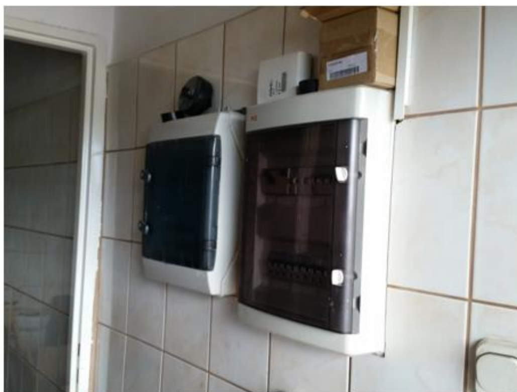
Rys. 4. Rozdzielnia główna w budynku
