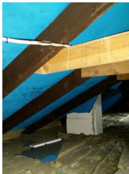
Rys. 2. Stan drewnianej konstrukcji dachowej budynku
