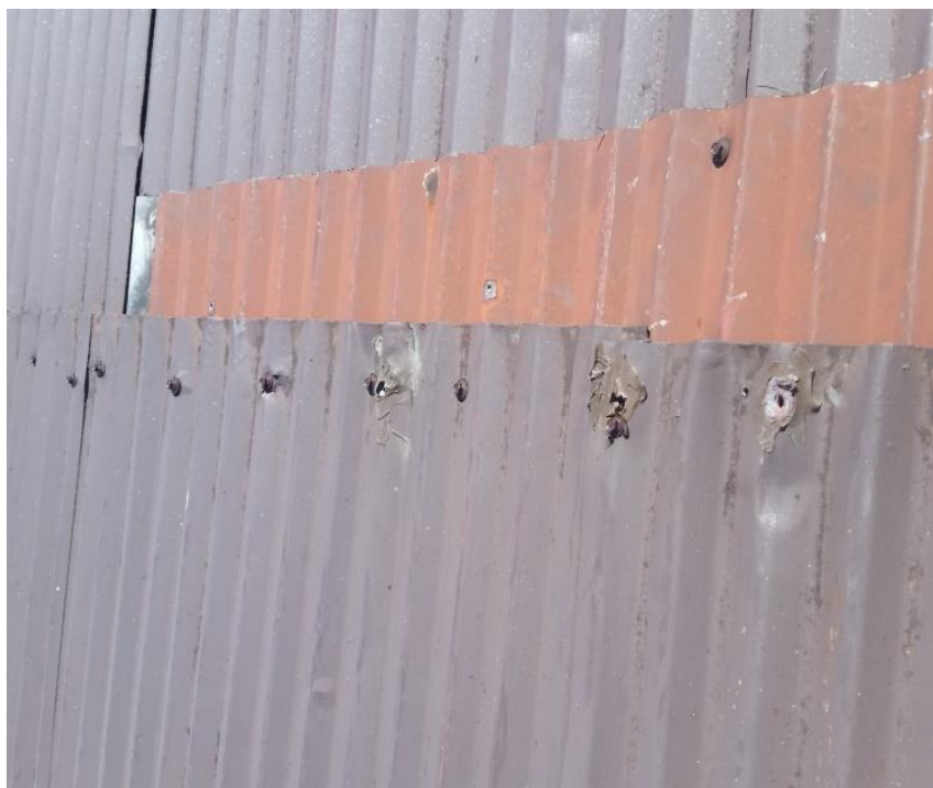
Rys. 3. Stan pokrycia dachowego
