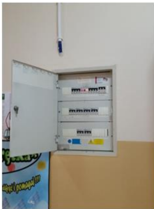
Rys. 4. Rozdzielnia główna w budynku
