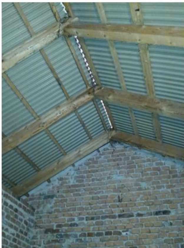
Rys. 2. Stan drewnianej konstrukcji dachowej budynku
