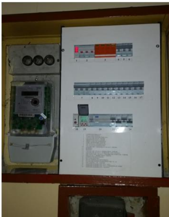
Rys. 4. Rozdzielnia główna w budynku
