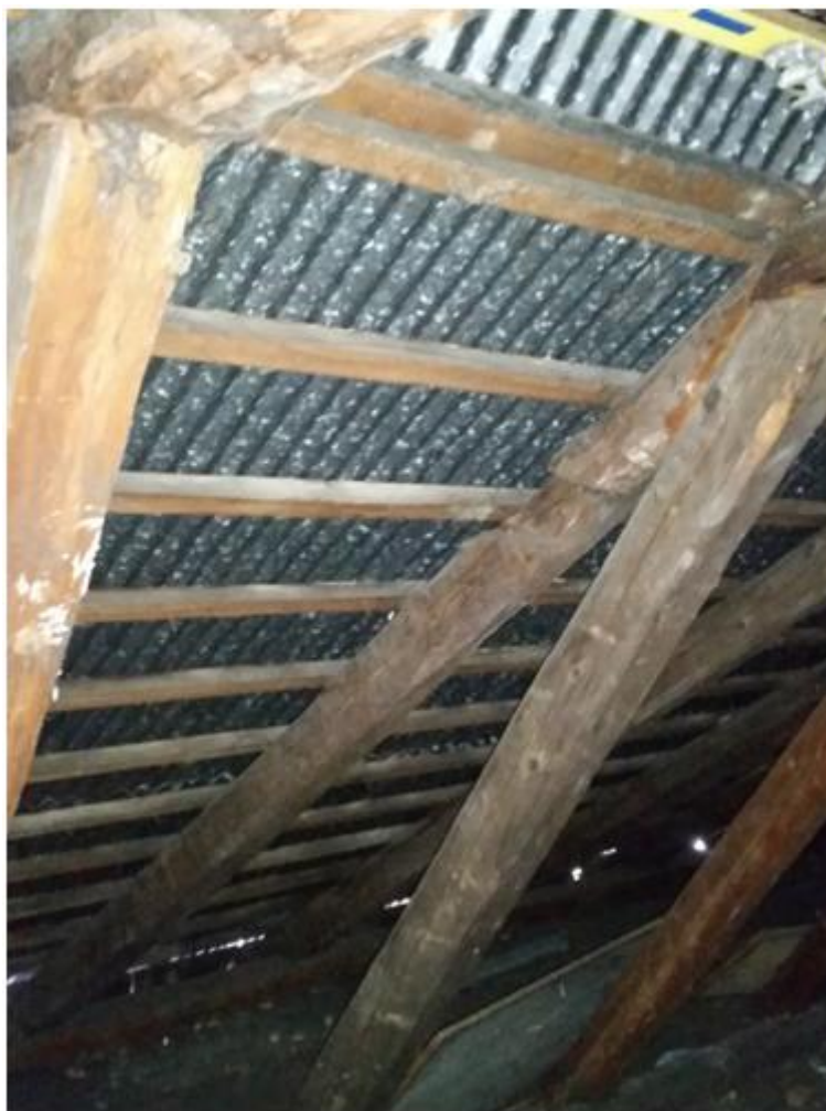
Rys. 2. Stan drewnianej konstrukcji dachowej budynku
